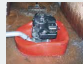
INUNDACIONES EN BAJOS Y GARAJES
